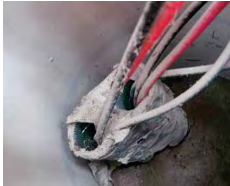
Fig. 6 - Hess Night Elements - Water in conduit
